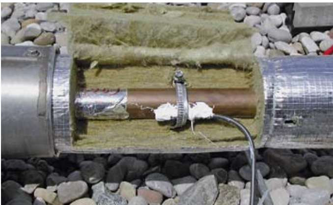
■ Bei den thermischen Sensoren ist eine stabile Anbringung wie auch eine gute thermische Anbindung wichtig ...
